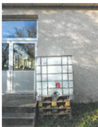
Cuve de récupération des eaux de cantine
