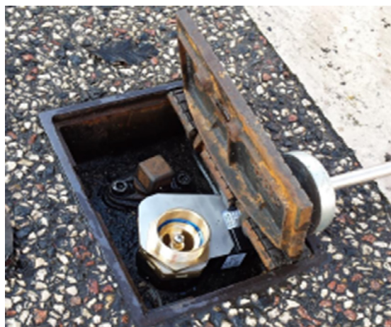
Bouche de lavage équipée d'un capteur TEMPO
